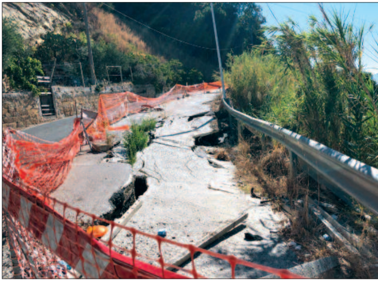
Sopra e a destra le condizioni delle strade provinciali interne
